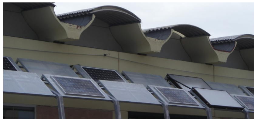
Esterno – Pensilina fotovoltaica
